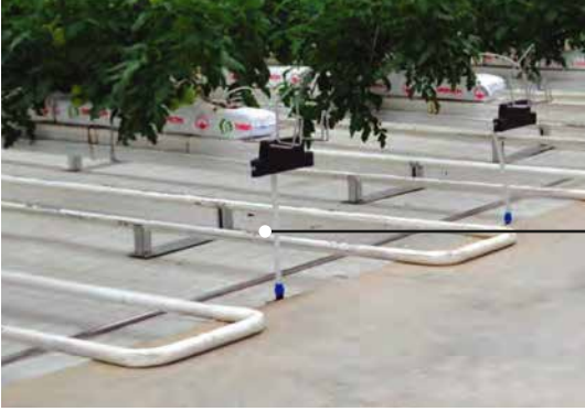
Isıtma Borusu Heating Pipe
